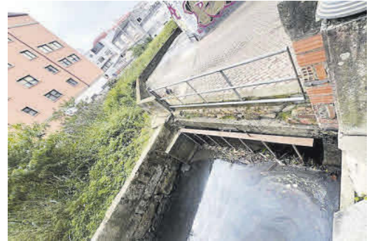
Residuos acumulados en el tramo de cauce de la calle Noria. | S.A.
